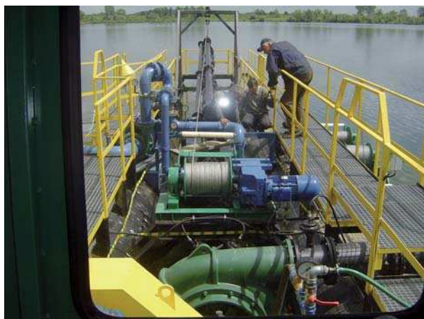
Fot. 1. Układ pompy na pogłębiarce ssącej
